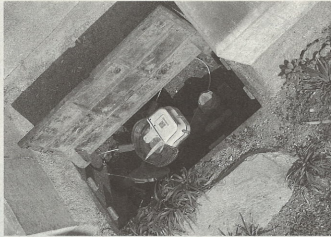
実証実験でのeMeter2の設置状況
