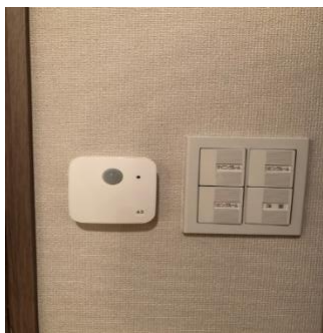
照明スイッチ隣に設置
